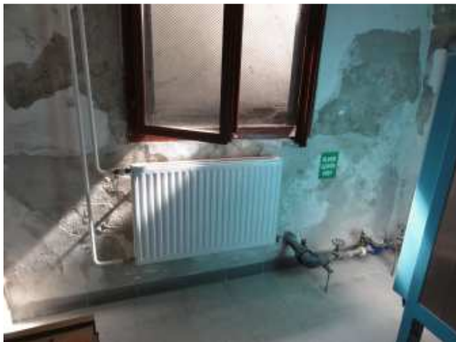
Foto č.13 – vysoce degradované omítkové systémy suterénního zdiva v prostoru technické místnosti
