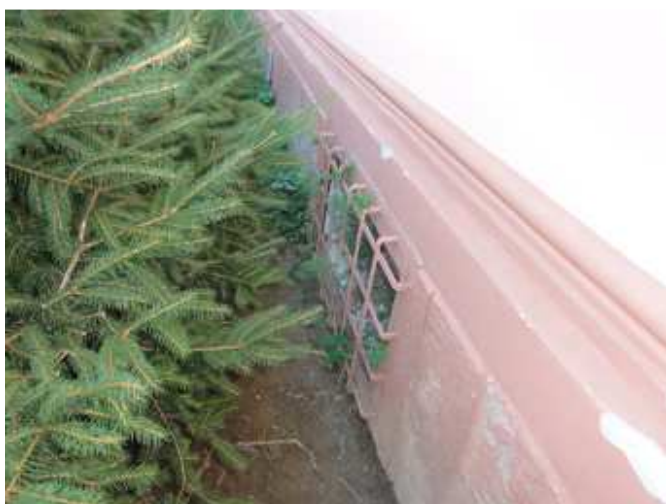
Foto č.8 – pohled na okapový chodník západní strany objektu. Vzrostlé stromy svým kořenovým systémem mohou narušovat konstrukci zdiva.
