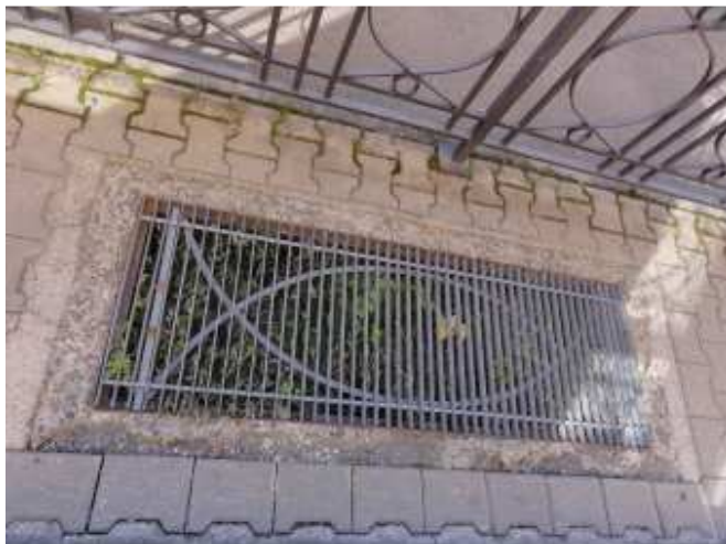
Foto č.6 – vegetací zarostlá zákrytová mříž bez účinného odvodnění a degradovanými betonovými stěnami
