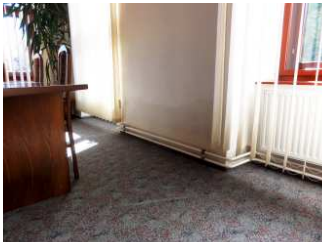
Foto č.10 – viditelná vlhkostní mapa v prostoru sborovny daná vlivem dožitých vodorovných a svislých izolací zdiva
