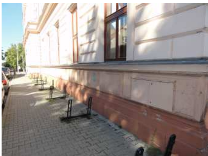
Foto č.3 – jižní strana posuzovaného objektu s viditelnými vlhkostními problémy
