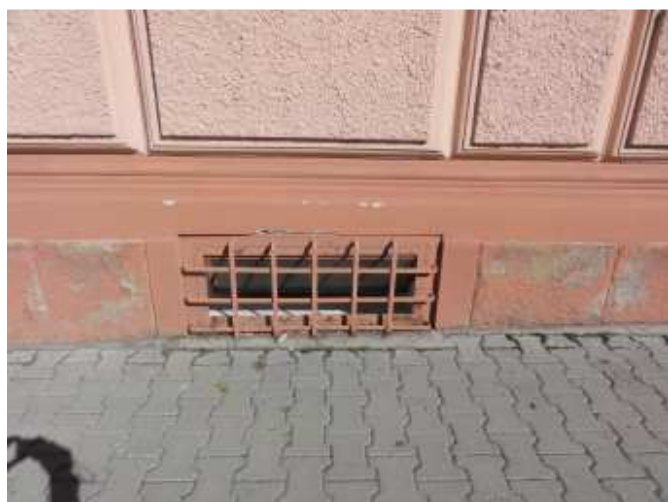
Foto č.4 – degradované nátěry pískovcového soklu dané vlivem vlhkosti a mrazivých cyklů
