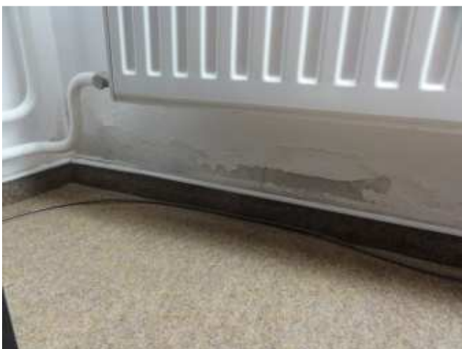
Foto č.11 – degradované omítkové systémy s opadávajícími povrchovými úpravami v prostorách kanceláří
