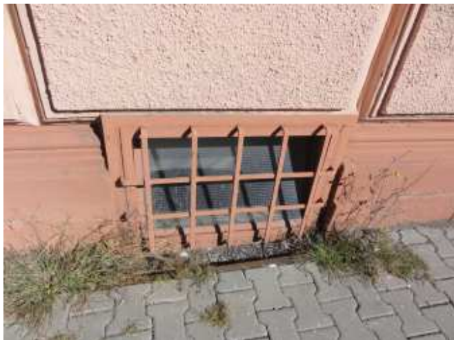
Foto č.5 – degradované anglické dvorky bez účinného odvodnění
