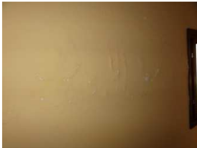
Foto č.14 – degradující povrchové úpravy zdiva v suterénním prostoru učebny cizích jazyků
