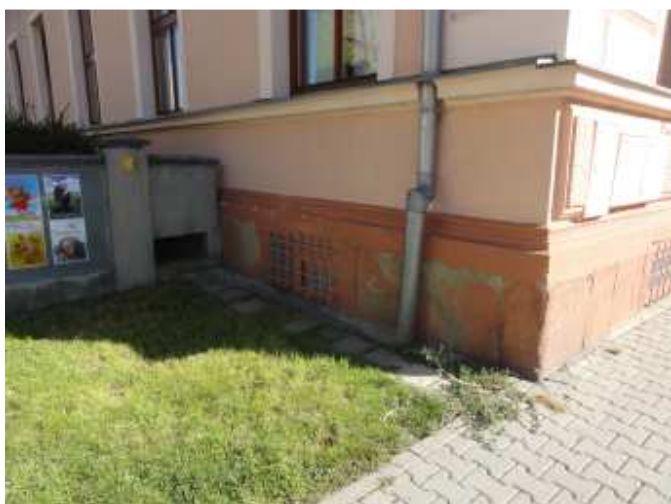
Foto č.7 – poškozený dešťový svod bez osazení lapače splavenin. Viditelná je také degradace povrchových úprav soklu.
