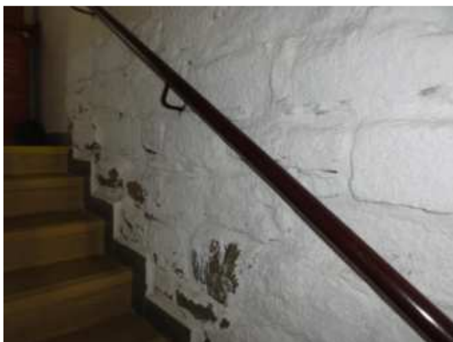
Foto č.12 – degradace povrchových úprav zdiva v prostoru přístupového schodiště do suterénu
