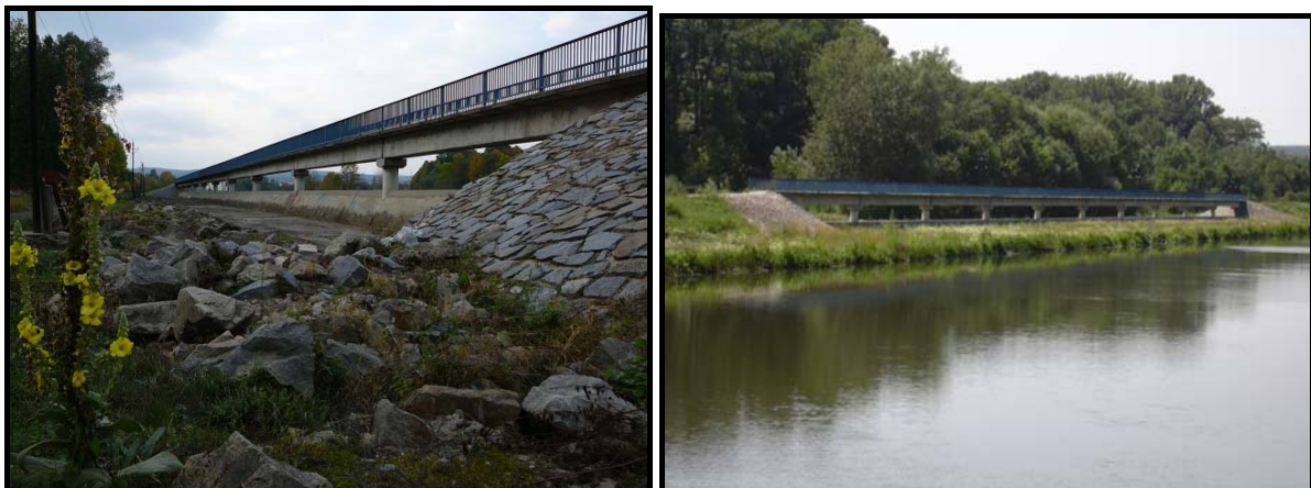
Obr. Boční přeliv do pravobřežní inundace nad jezem Bulhary na řece Dyji
