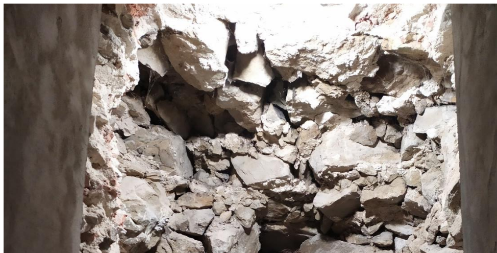
Obrázek 14 Poslední zbytek meziřůčských hradeb zachovaný v budově jižního křídla zámku Žerotínů (foto autor)
